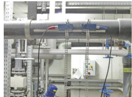
Wärmemengenmessung Stadtwerke München
